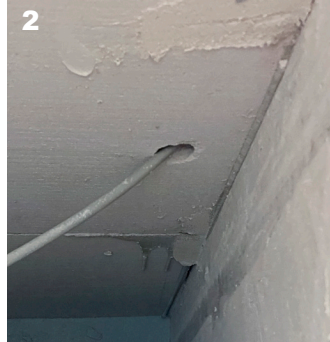
2 L'espace autour du trou de câblage est trop grand, il aurait dû être calfeutré.
